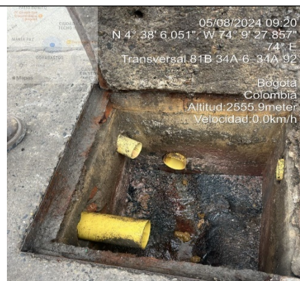
Foto No.7. Caja de Inspección Externa TV 81B - ARD
