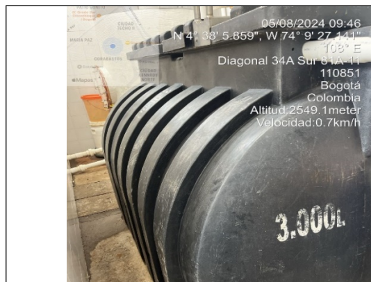
Foto No.4. Tanque de floculación
